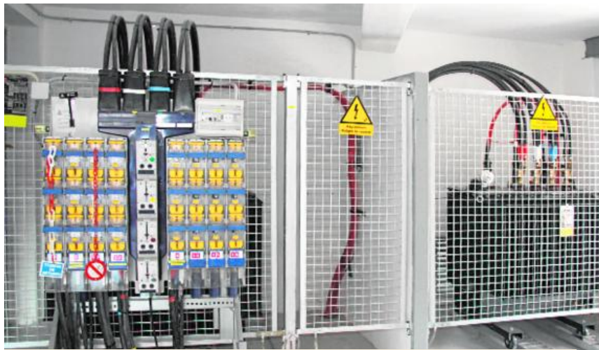
Centro de transformación de una de las cooperativas eléctricas valencianas en la plaza de Abastos. LP
