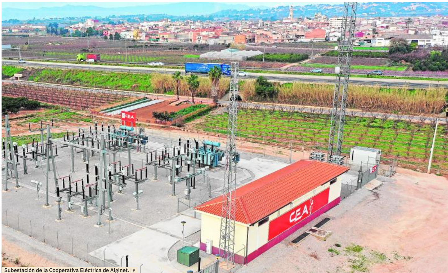
Subestación de la Cooperativa Eléctrica de Alginet. LP
